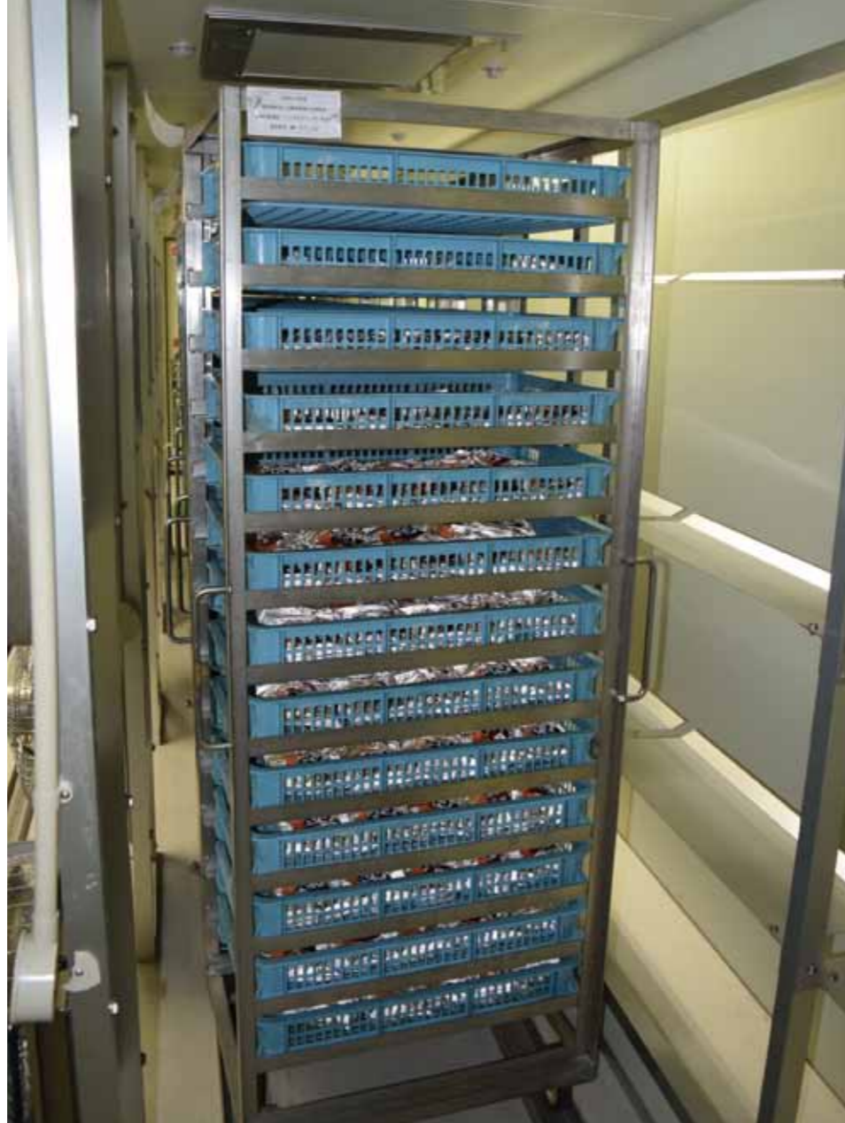
商品を70度Cから5度Cに下げる独自開発したトンネル冷却装置
