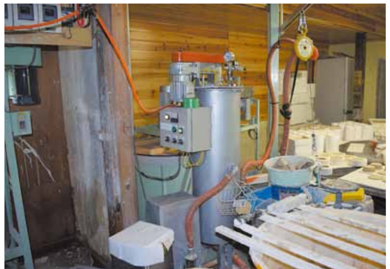
歩留まりを向上させた、流し込み排泥鑄込み用設備
