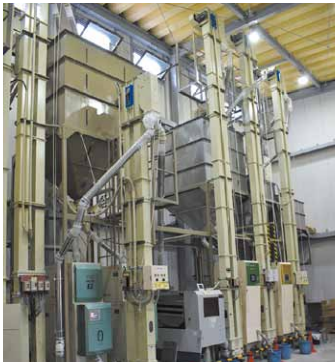
高品質なもち米を生産する精米加工設備
